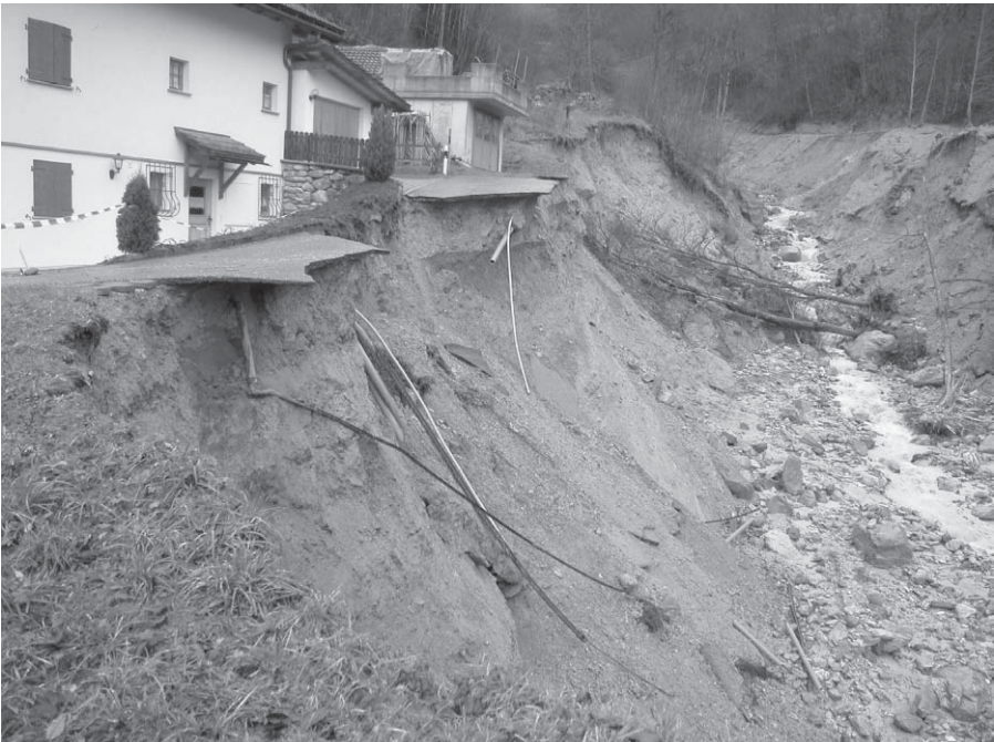
Abb. 6: Im Val Valdun erreicht die Seitenerosion im Dorfbereich etwa 7 m. Zerstörte Zufahrtswege und geborstene Leitungen sind die Folge.
