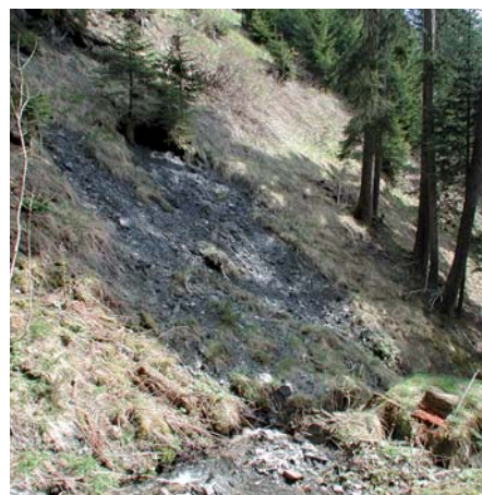
Beispiel für Böschungsbaustein mit mittlerer Aktivierungswahrscheinlichkeit. Entlang dieses Abschnittes kam es lokal zu Nachrutschungsprozessen. Die übrigen Bereiche weisen momentan keine Anzeichen von Aktivität auf. Die Grunddisposition ist jedoch gegeben, so dass bei grösseren Ereignissen weitere Nachböschungen möglich sind (Schauensteinertobel, Cazis, GR).
